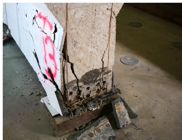
Figura 19. Deslizamiento de la armadura longitudinal.
