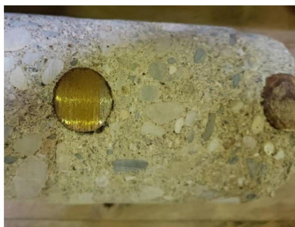
Figura 9. Estado de las armaduras en el interior del hormigón.
