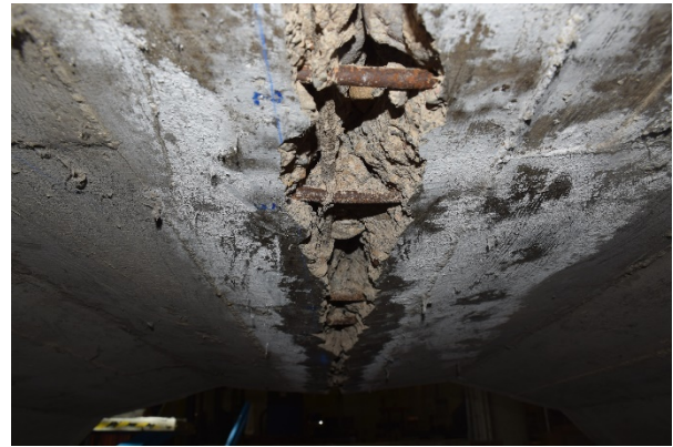
Figura 11. Vista inferior de la pieza 1 al final del ensayo.
